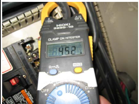
8. 更換Pedrollo 15HP 節能泵浦後側得電流值45.2A
