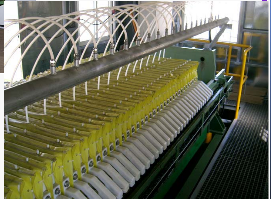
膜片型壓濾機俯視
